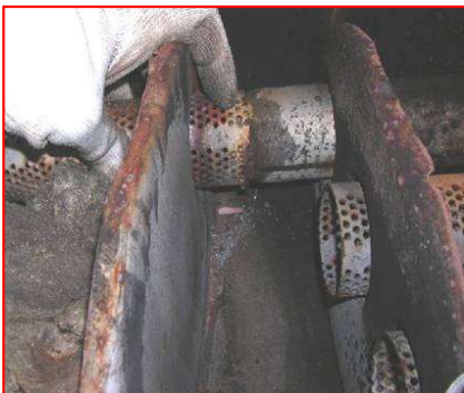
Escape oxidado por el agua retenida
